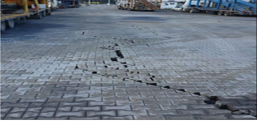
Şekil 67 – İskenderun Limanında Tır park alanı zeminindeki çatlaklar
