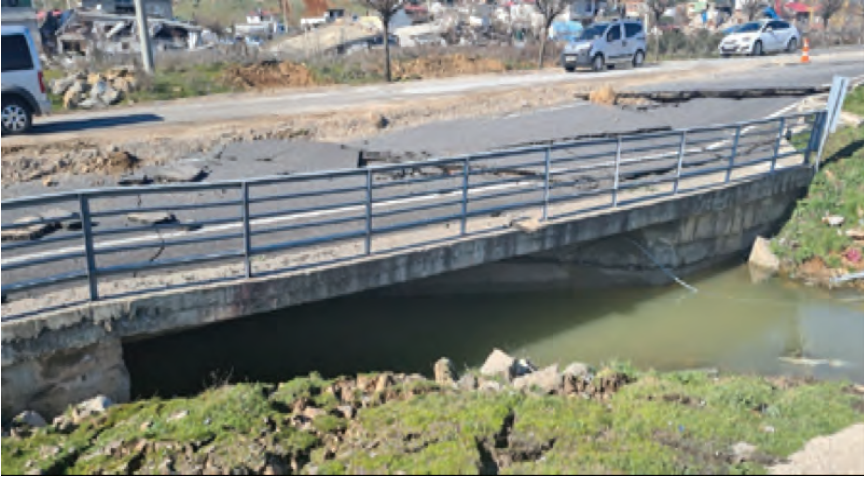
Şekil 73 – Nurdağı-Kahramanmaraş karayolundaki köprü çökmesi
