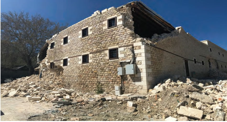
Adiyaman Yakın dönemde restorasyon uygulamaları geçiren Tuz Hanında hasarlar
