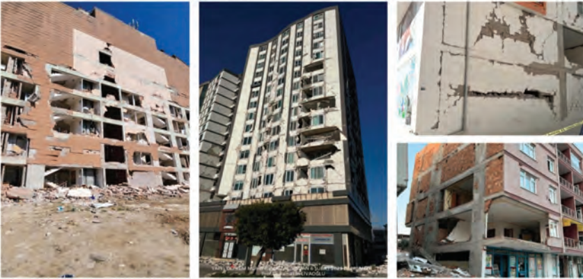
Yapısal olmayan bina hasarlarına örnek
