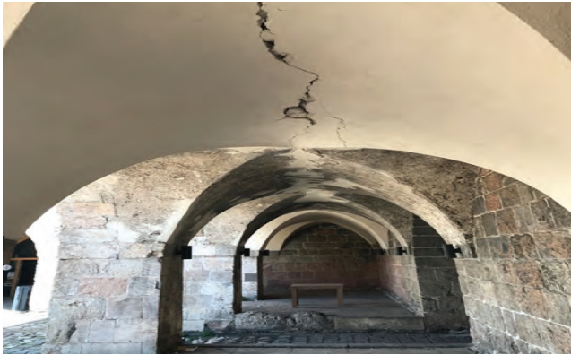
Payas, Sokullu Mehmet Paşa Kervansarayı kuzey revağı
