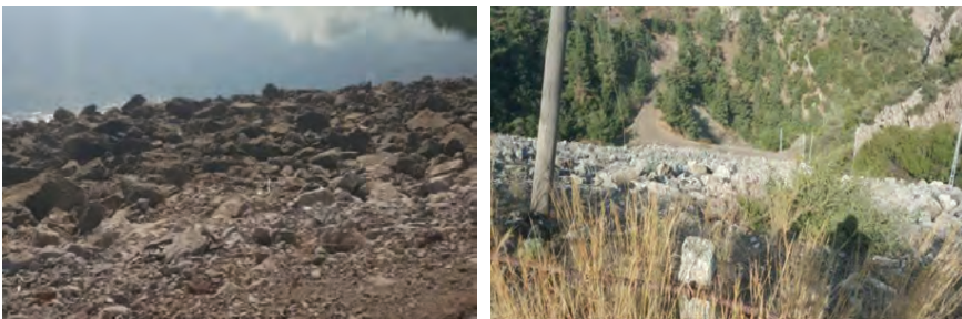
Şekil 34- Kalecik baraj gövdesi memba şevindeki deformasyon (sol)
