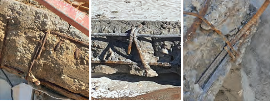
Yıkılan binalardaki etriyelerin büküm şekilleri (Adana)
