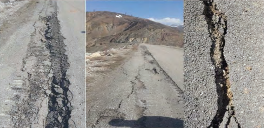
Şekil 13- Çat Barajı kretindeki sistematik çatlaklar ve yanıl yayılmalar
