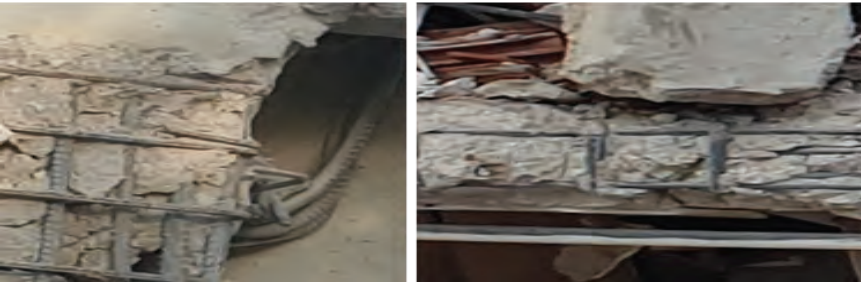
Yıkılan binalardaki etriyelerin büküm şekilleri (Antakya)
