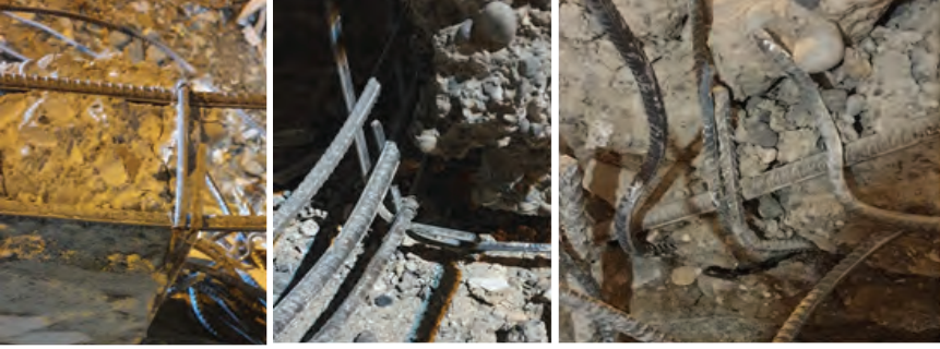
Yıkılan binalardaki etriyelerin büküm şekilleri (Adana)
