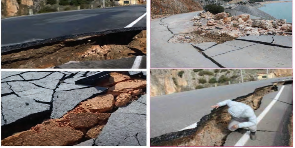
Şekil 6- Kartalkaya barajı gövdesindeki tipik hasarlar
