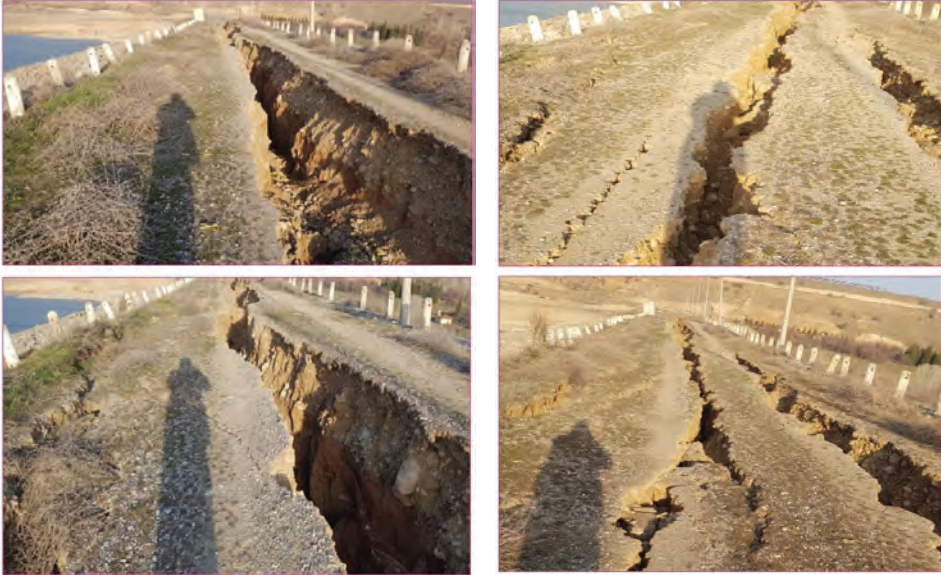
Şekil 3- Sultansuyu barajının depremden 10 gün sonraki görüntüleri
