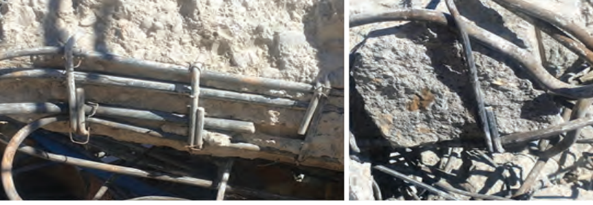
Yıkılan binalardaki etriyelerin büküm şekilleri (Besni)
