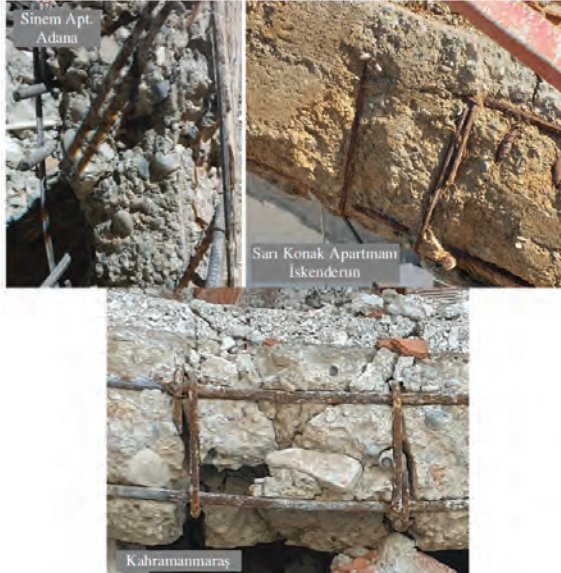
Yıkılan bazı binalarda gözlenen beton kalitesi
