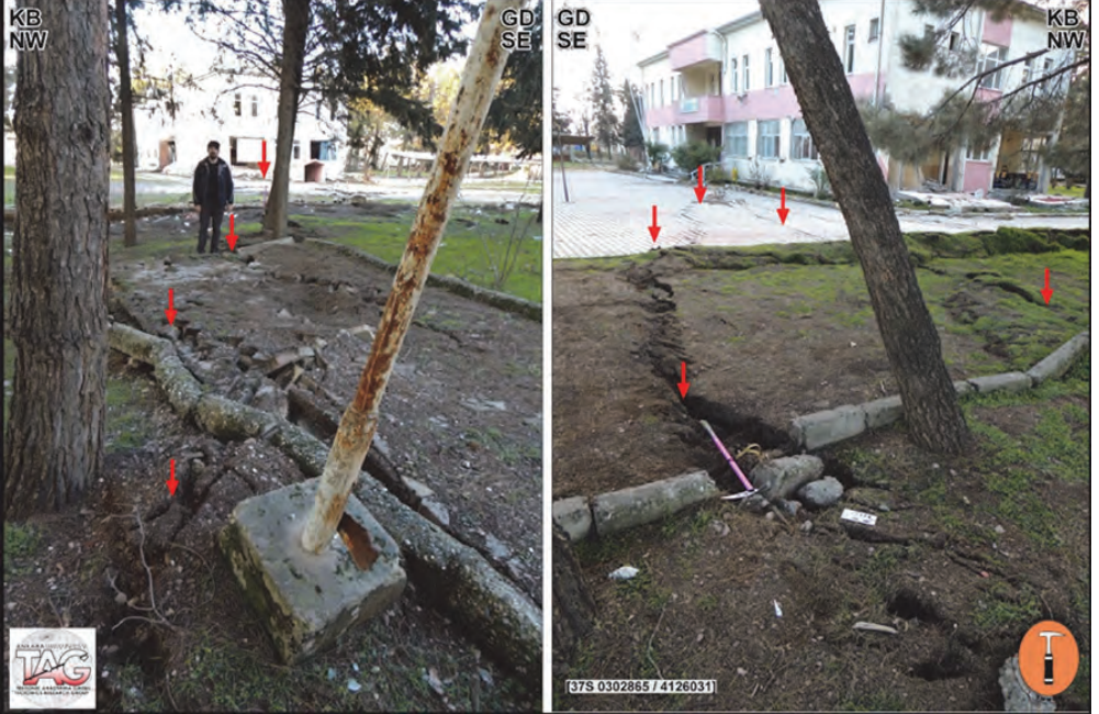
Şekil 12d: Yüzey yırtılmasının Şekeroba İmam Hatip Ortaokulundaki hasar ile ilişkisi. Konumlar için Şekil 12e'ye bakınız.
