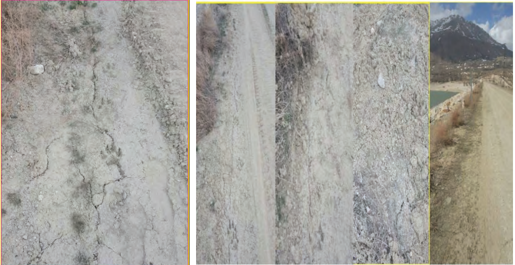
Şekil 20- Polat Barajı kretinde oluşan kılcal çatlaklar (sol)
