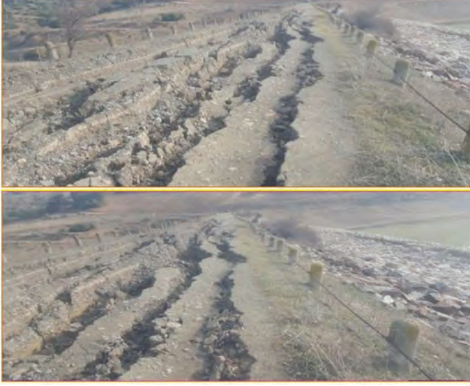
Şekil 28- Arıklıkaş baraj kretindeki derin çatlaklardan detaylı görüntü
