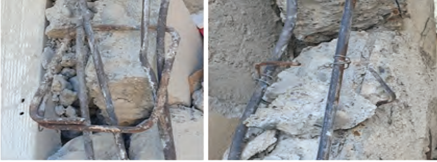
Yıkılan binalardaki etriyelerin büküm şekilleri (Osmaniye)
