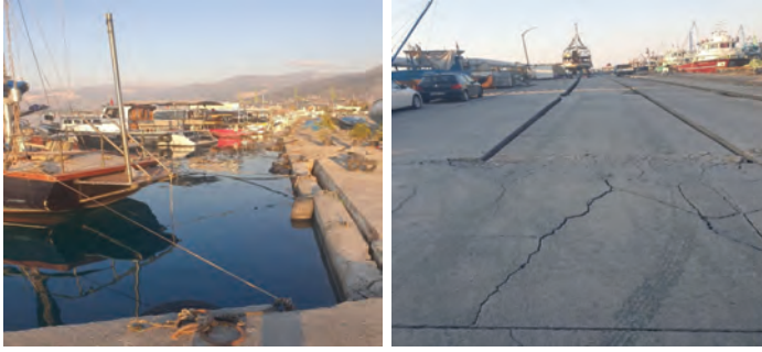
Şekil 5: İskenderun Balıkçı Barınağındaki yapısal hasarlar
