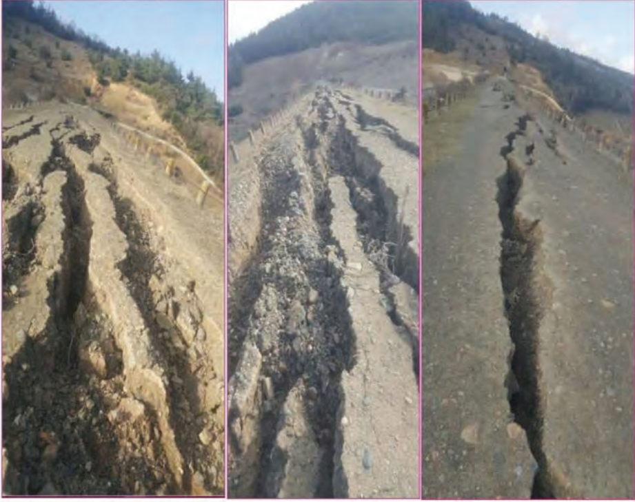
Şekil 29- Arıklıkaş baraj kretinde derin çatlaklar (ağır hasar)
