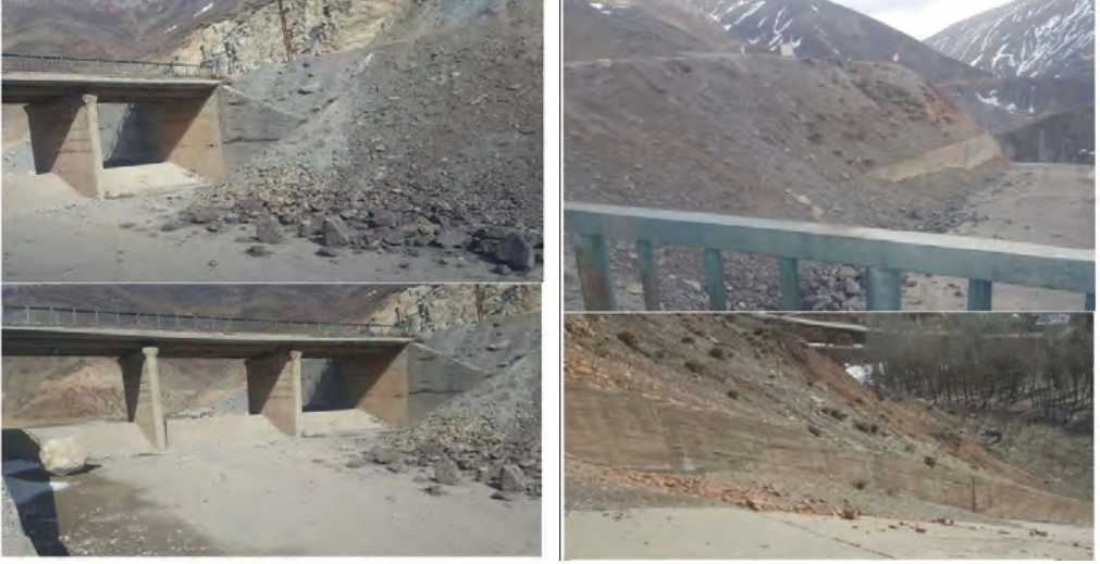
Şekil 17- Dolusavak yapısının olduğu yerde meydana gelen kaya düşmeleri ve moloz akmaları (sol)
