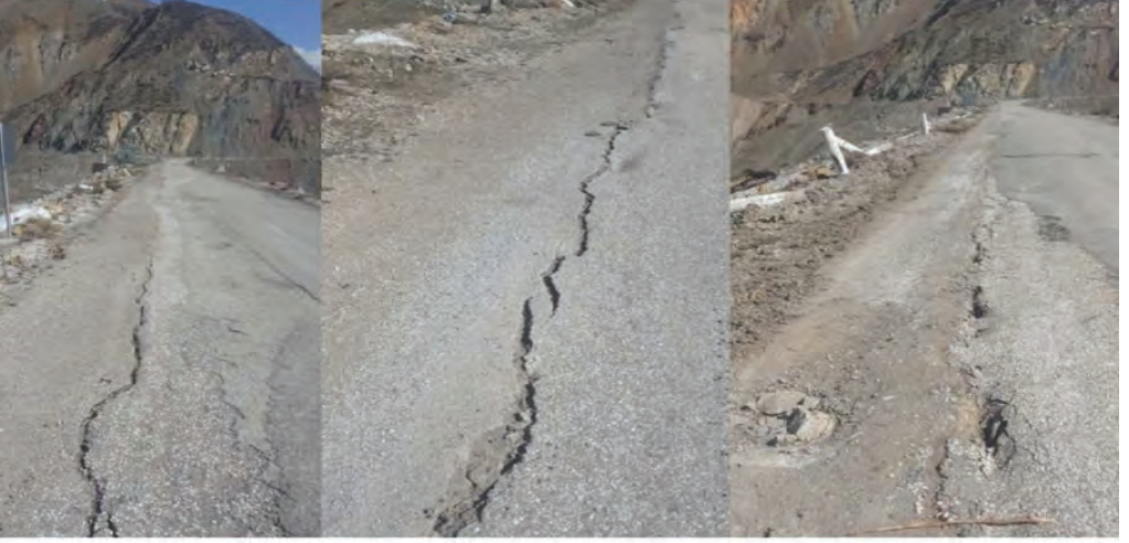
Şekil 12- Çat Barajı kretindeki sistematik çatlaklar
