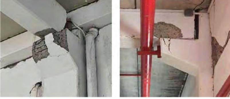
Kısa Konsol Hasarı
