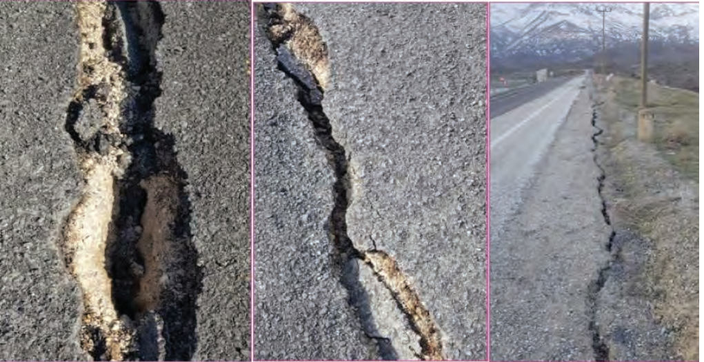
Şekil 10- Dolgunun çeşitli yerlerindeki çatlaklar ve yerel çökme alanları
